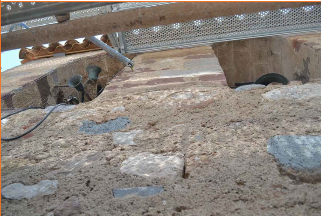
Foto 16. Vista de la façana sud (MR-9) del campanar i de les obertures UEs 122 i 123.
