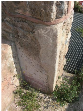
Foto 12. Morter de revestiment amb policromia
