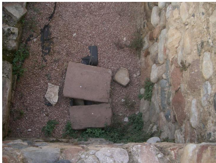
Foto 3. Mostres d'atacs vandàlics: caiguda i moviment de pedres i aixecament del geotèxtil
